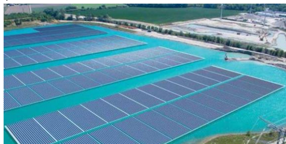
Centrale flottante de Piolenc ©Akuo Energy
