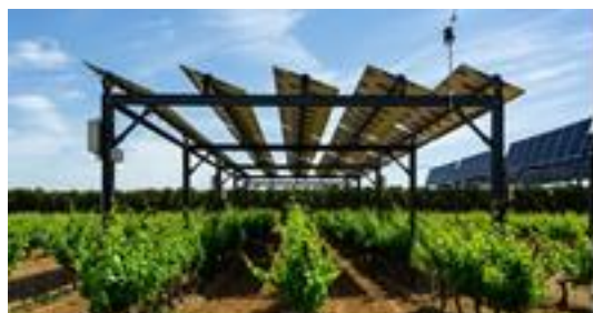
Centrale vitivoltaïque de Tresserre © Sun'R
